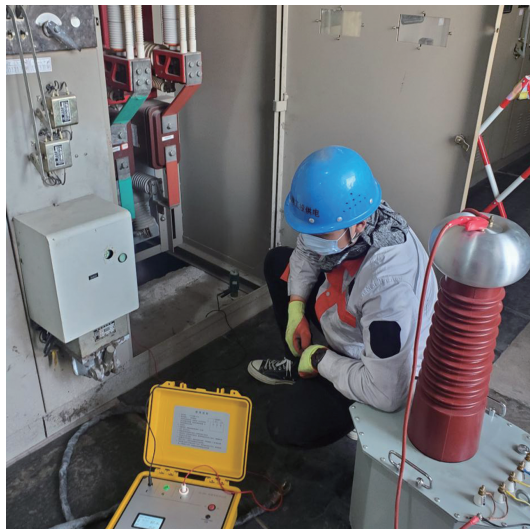
4月21日，供电工程分公司工程营销部试验班组前往徐南封跳变电所，对方洋线和养殖线等六条出线柜进行系统化电力试验，为变电所安全稳定运行保驾护航。(李杨)
