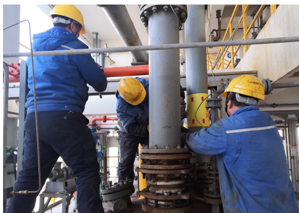
3月1日,利海化工公司启动了为期 10 天的设备大修工作,对双氧水、氯化苯装置尾气机组、氧化塔、氢压机等 36 个项目展开检修。图为员工检修氯化苯装置反应系统。(徐洁)
