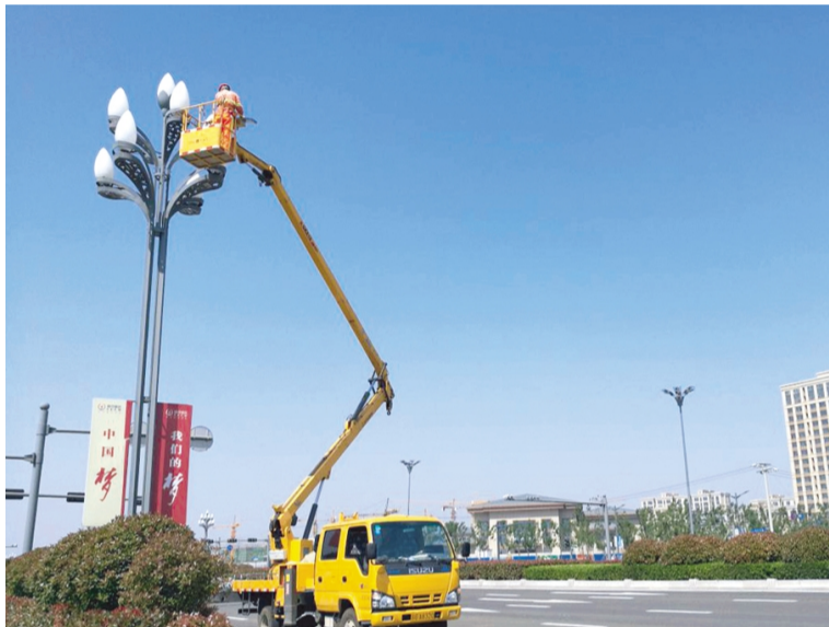
连日来,徐圩悦升市政分公司全体干部员工顶烈日,战高温,坚持每天工作8小时,晚上加班巡查,精准实施500余套LED路灯更换安装工程,计划改造路段有徐新路、上海路、合作路等,及时亮化新区夜晚路灯照明环境,提升路灯养护信誉,为推动市政业务拓展升级提供保障。
